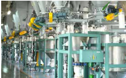
原料計量 Dosing equipment
