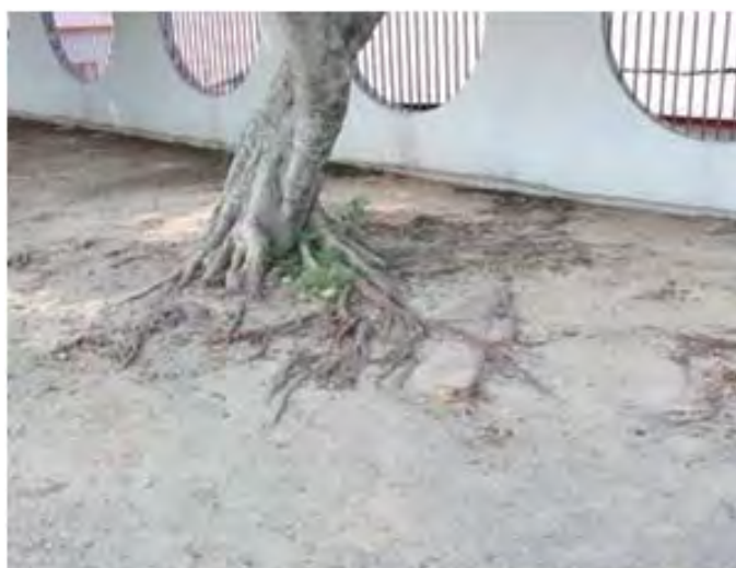
造成嚴重浮根現象。
