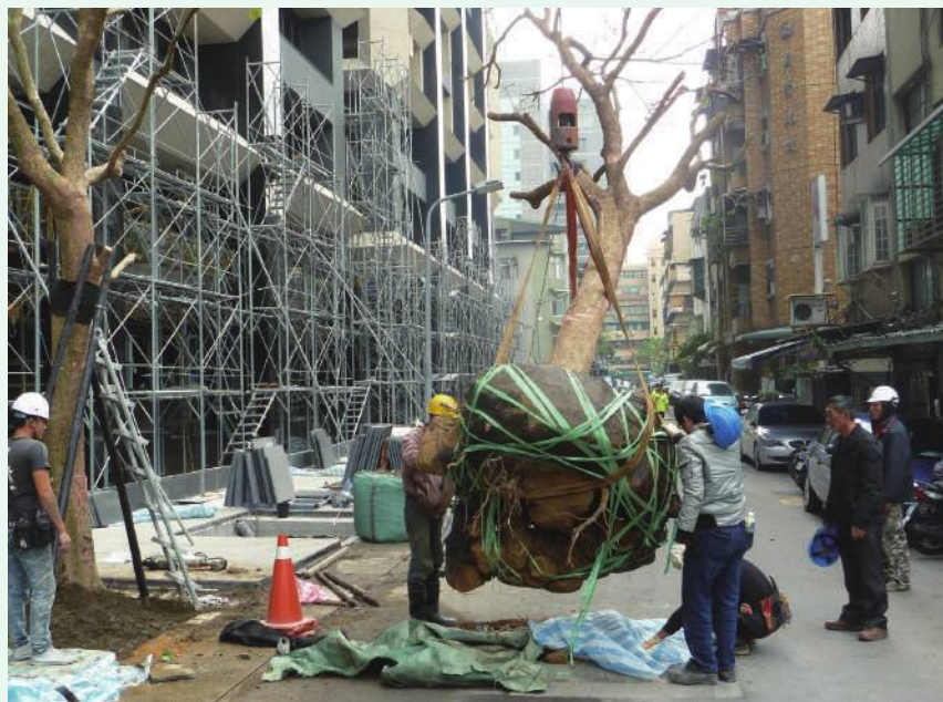
土球在運輸過程破裂，是施工上常見的事。
