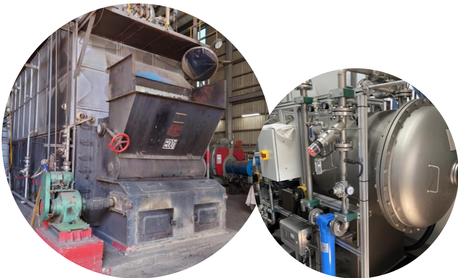
燃煤鍋爐+臭氧脫硝
